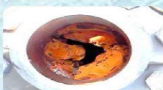
築33年経過した給水管の内部
