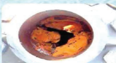
築33年経過した給水管の内部
